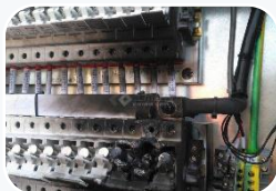
直流配电柜烧毁
