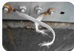
直流接地破损
