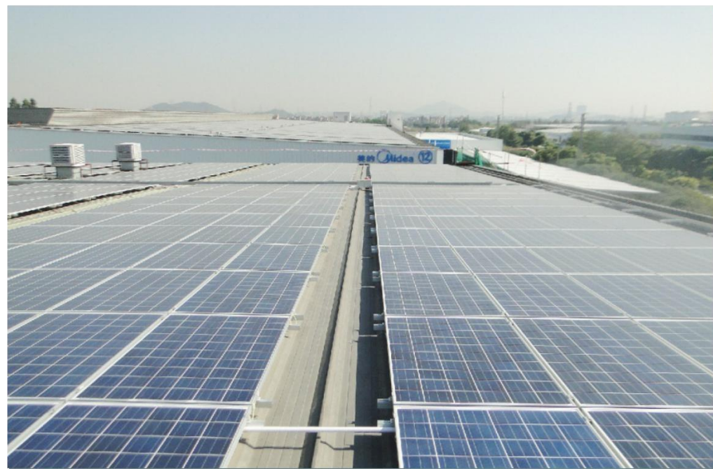
美的项目为屋顶光伏项目
